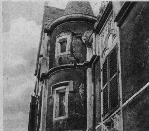
Risse in der Fassade.
